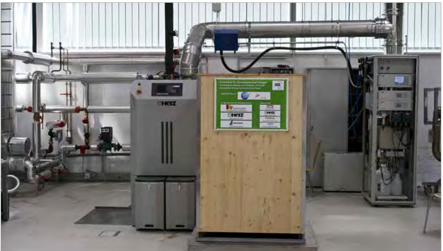
Kesselprüfstand und Versuchsanordnung für das Projekt ENEREED in der FH Pinkafeld.
