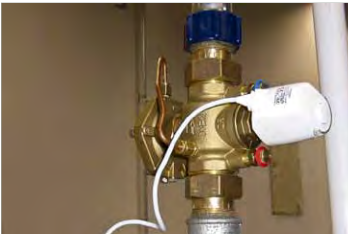
Eines der vielen eingesetzten Kombiventile HERZ 4006.
