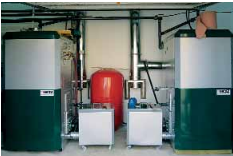
Die aus kleinen Chalets bestehende Appartementanlage Lachat wird mit zwei 90 kW-HERZ-Anlagen zentral mit Wärme versorgt.
