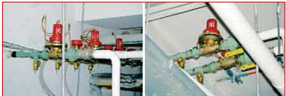
2004 wurden die Steigstränge mit HERZ-Strangregulierventilen 4217 und HERZ-Differenzdruckreglern 4007 nachgerüstet und die Anlage einreguliert.
