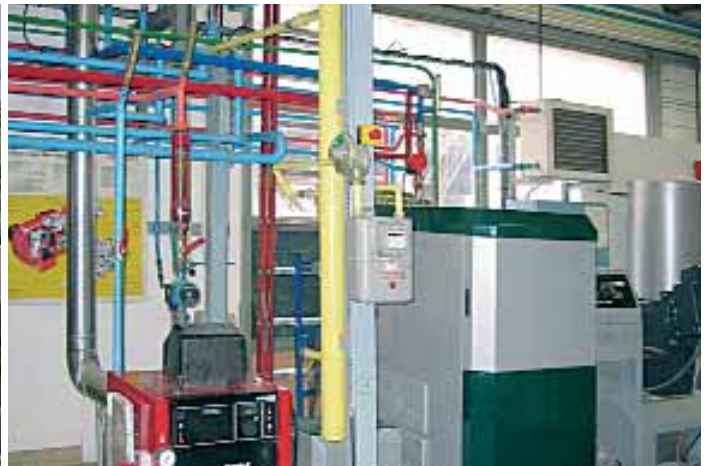
Am Lycéé Amberieu, einer Fachschule für Installateure, üben die Schüler direkt am Objekt das Installieren, Einstellen und Warten einer Heizungsanlage. Neben Öl-, und Gaskesseln ist hier eine HERZ-Hackschnitzelanlage (25 kW) in Betrieb.
